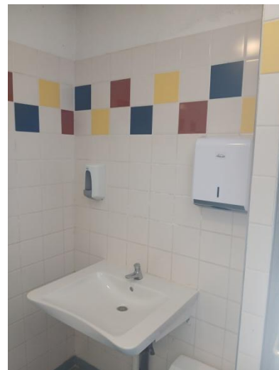
Distributeur de savon et distributeur de serviettes accessible PMR
